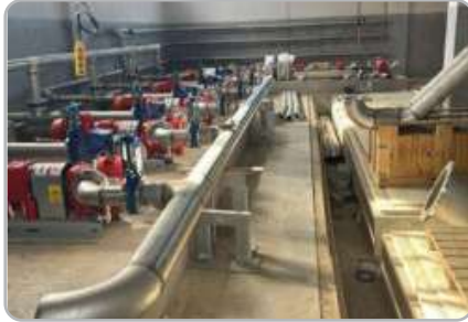
Pompa Blower Mikser
